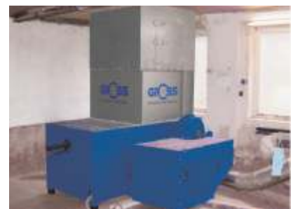
GAZ 102 Unterflur aufgestellt, mit Trichterweiterung
